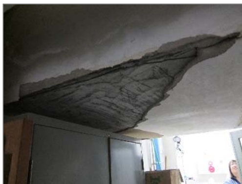
躯体の劣化(本庁舎)
