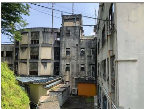
建物の老朽化(本庁舎)
